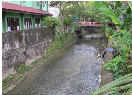
Gambar 5. DAS depan MTs setelah perbaikan (Sumber : Sulardi, 2017)
